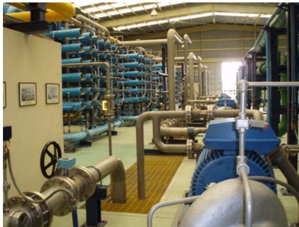
Figura 1 Vista general de la planta
